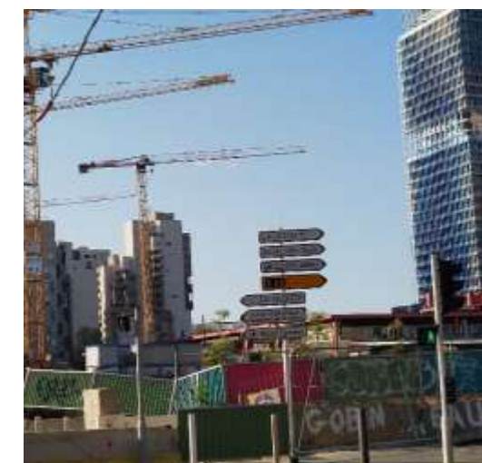
A droite : la tour La Marseillaise vue depuis l'îlot Château Vert
