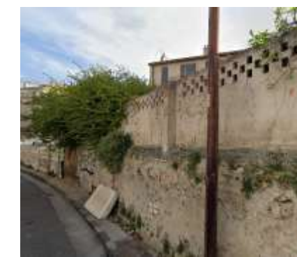
Végétation privée dépassant sur l'espace public dans la traverse de Château-Vert
