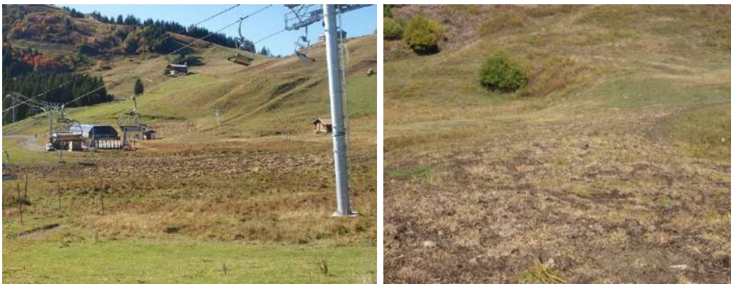
Photo 5 Etrépage-Résultats de replaquage sur des travaux de réseaux sur le domaine skiable du Giffre-Samoëns (photo 2019, année des travaux)
