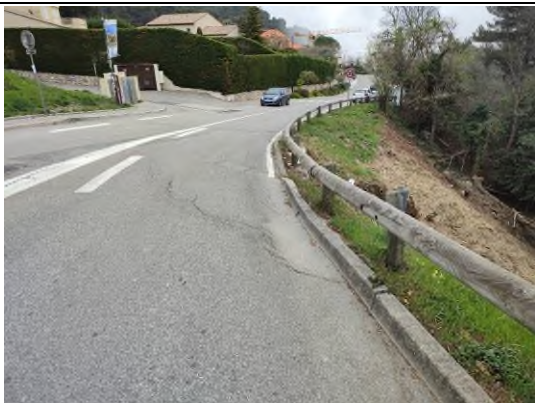
Affaissement sur chaussée (zone de remblais)
