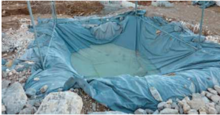
Exemples de fosses étanches de récupération des résidus de nettoyage des goulottes des toupies béton (ECO-MED)
