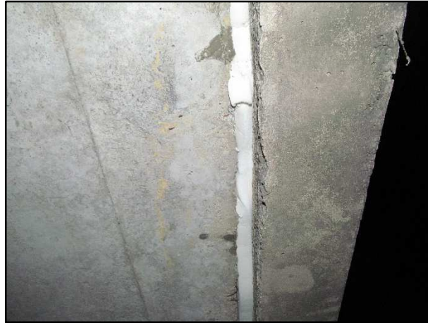
Matériaux utilisés pour boucher sur ouvrage d'art (de haut en bas, de gauche à droite) : mousse polyuréthane, joints en mousse cylindriques ou carrés, association des deux
