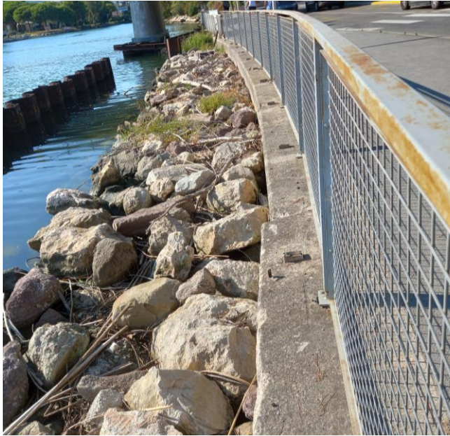
Déformation de la berge (déplacement de blocs, mur béton)
