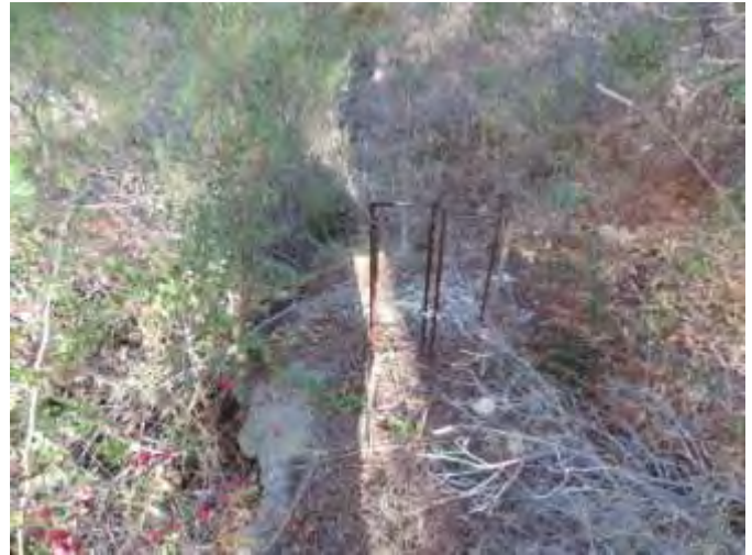
Ferrailles dépassant de fondations de constructions 3 octobre 2017
