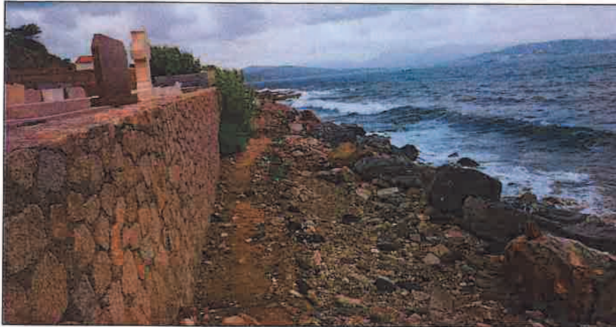
Photo n°4 – Sentier piétonnier à reprendre - ICTP février 2018
