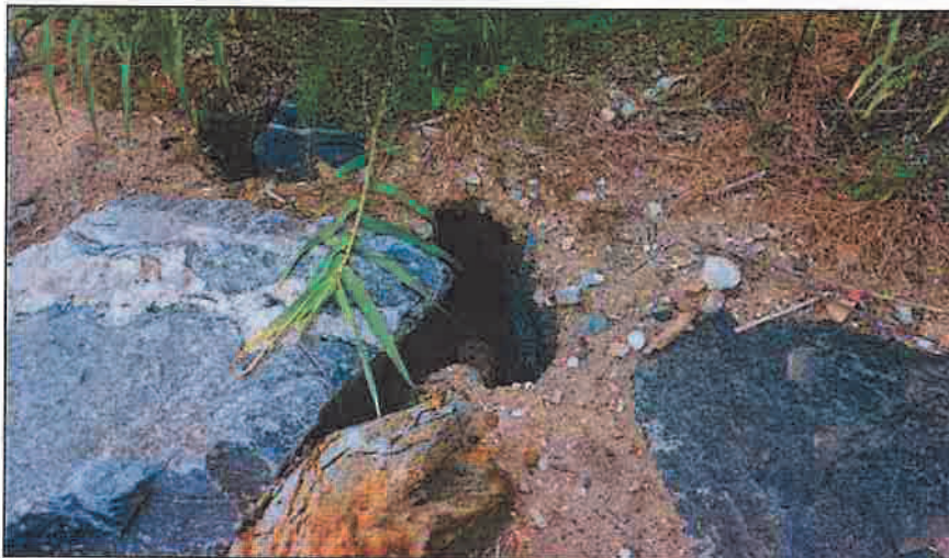
Photo n°5 – Cavités entre les enrochements au niveau du mur de soutènement - ICTP juin 2018
