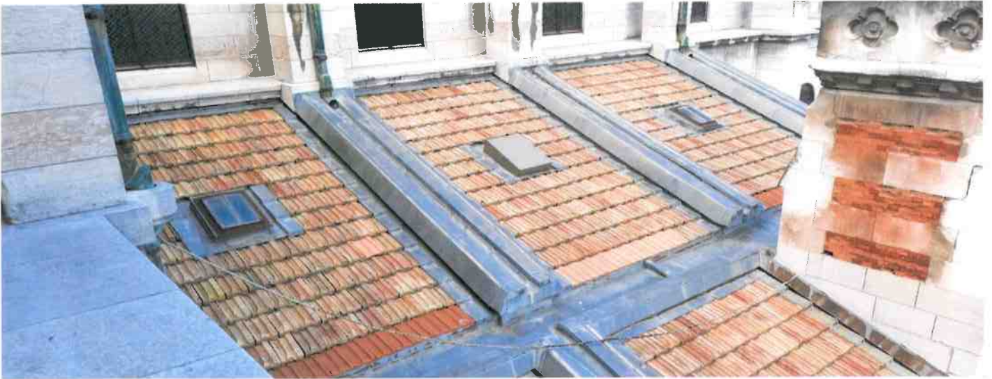
Etat des couvertures du bas-côté Sud (lanterneaux altérés, zingueries deficientes, tuiles de différents modèles, nombreuses tuiles cassées)
