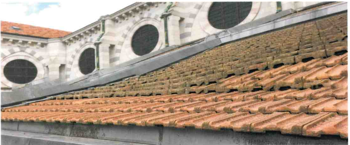
Couvertures des bas-côtés (rangs de tuiles de différents modèles témognant de réparations)
