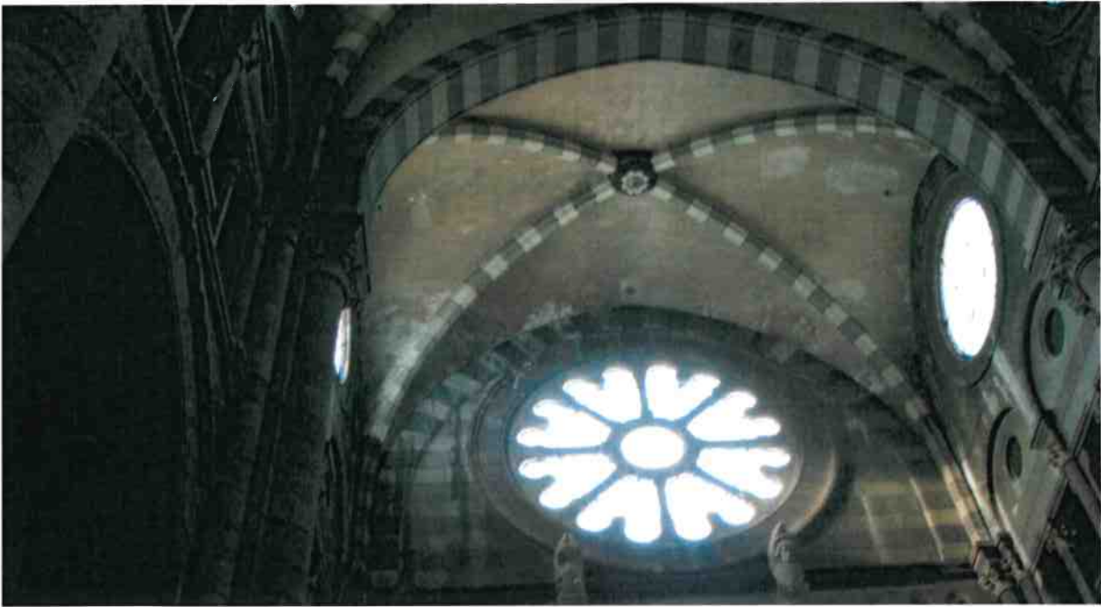
Désordres sur l'intrados des voûtes du transept
