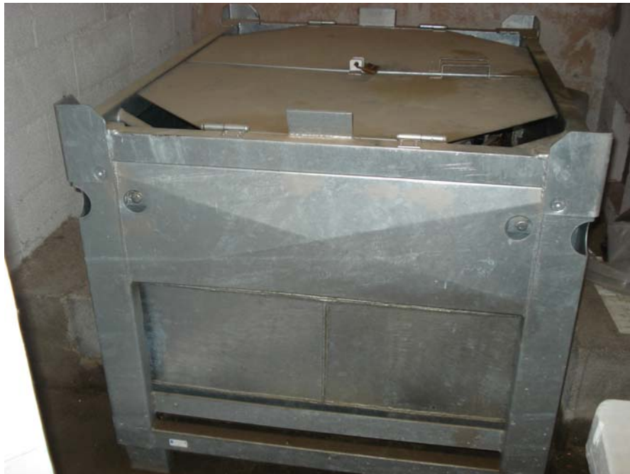
Figure 20 : Cuve à fioul n°1 dans le bâtiment principal (aile Nord Ouest)
