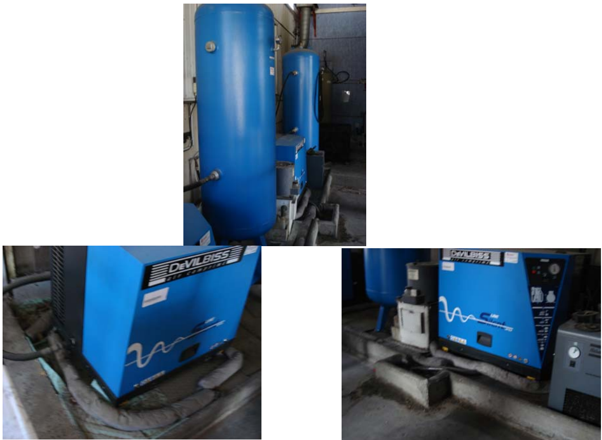
Figure 22 : Installation d'air comprimé présentant des fuites d'huile
