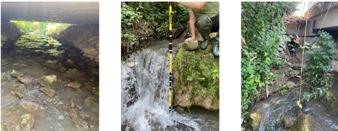
Figure 73 : vue générale sous le pont de le d572 ; cascade visible en aval du pont ; rejet visible en aval immédiat du pont
