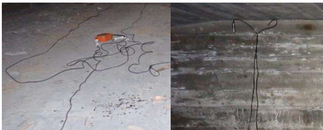
Figure 5 : Sondes installées dans le pont, à droite le boîtier HOBO et à gauche les sondes du HOBO - © GCP
