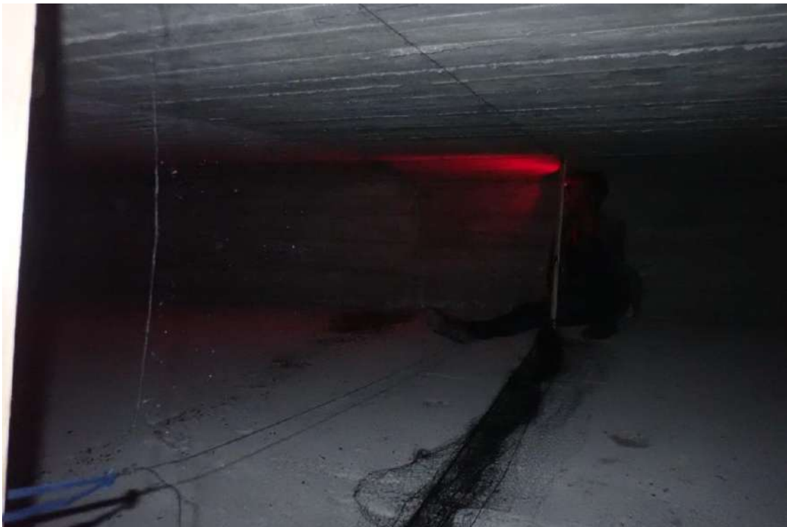
Photographie 6 : Filet posé à l'intérieur d'un caisson du pont de Riou Bourdou. © Jean Caroline (GCP), 2021
