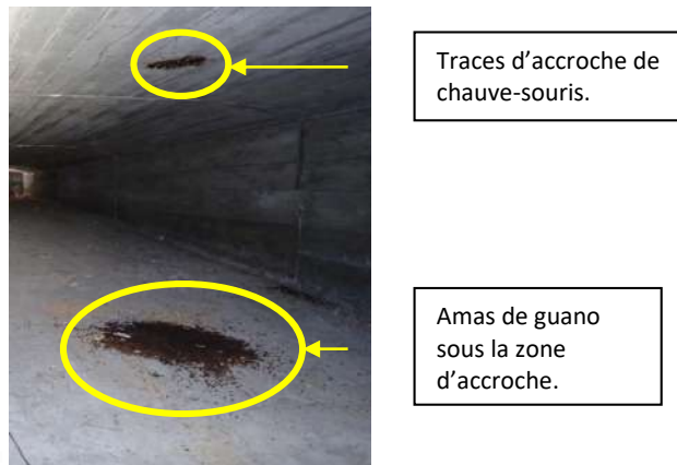
Figure 50 : Indice de présence indirecte de présence de Chiroptères dans un caisson du pont de Riou-Bourdou.
