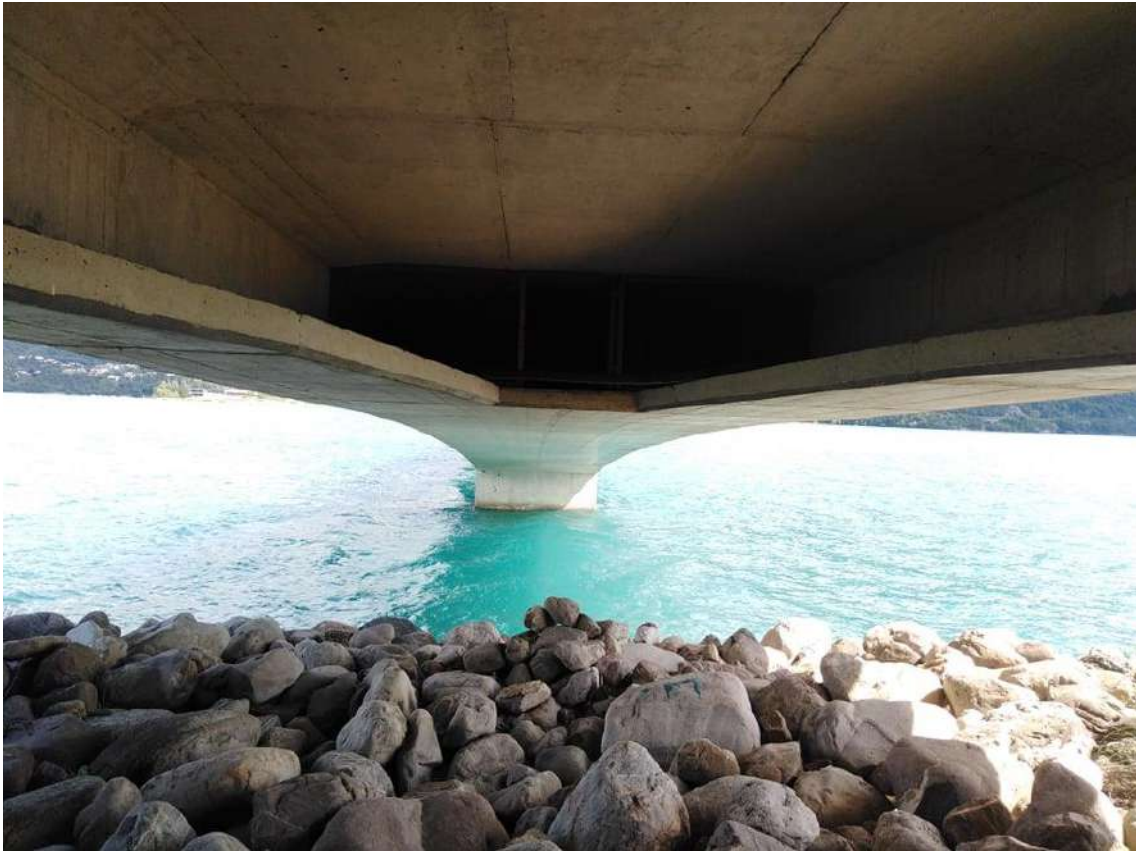
Photographie 3 : Entrée du caisson de culée nord du pont de Savines accessible sans équipement. © Théo Defrancq (GCP), 2021
