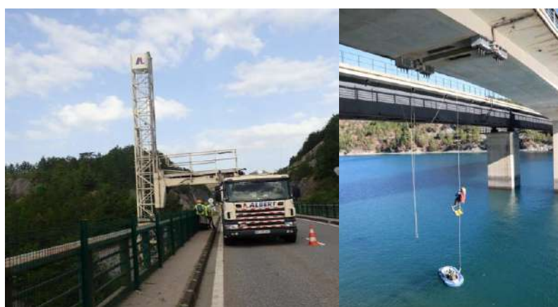
Figure 3 : Les deux modes d'accès aux caissons du pont, à gauche la nacelle et à droite l'accès corde - © GCP
