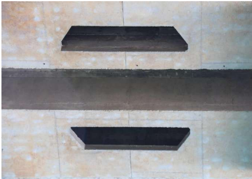
Photographie 2 : Entrée des caissons du pont de Riou Bourdou. © Jean Caroline (GCP), 2021
