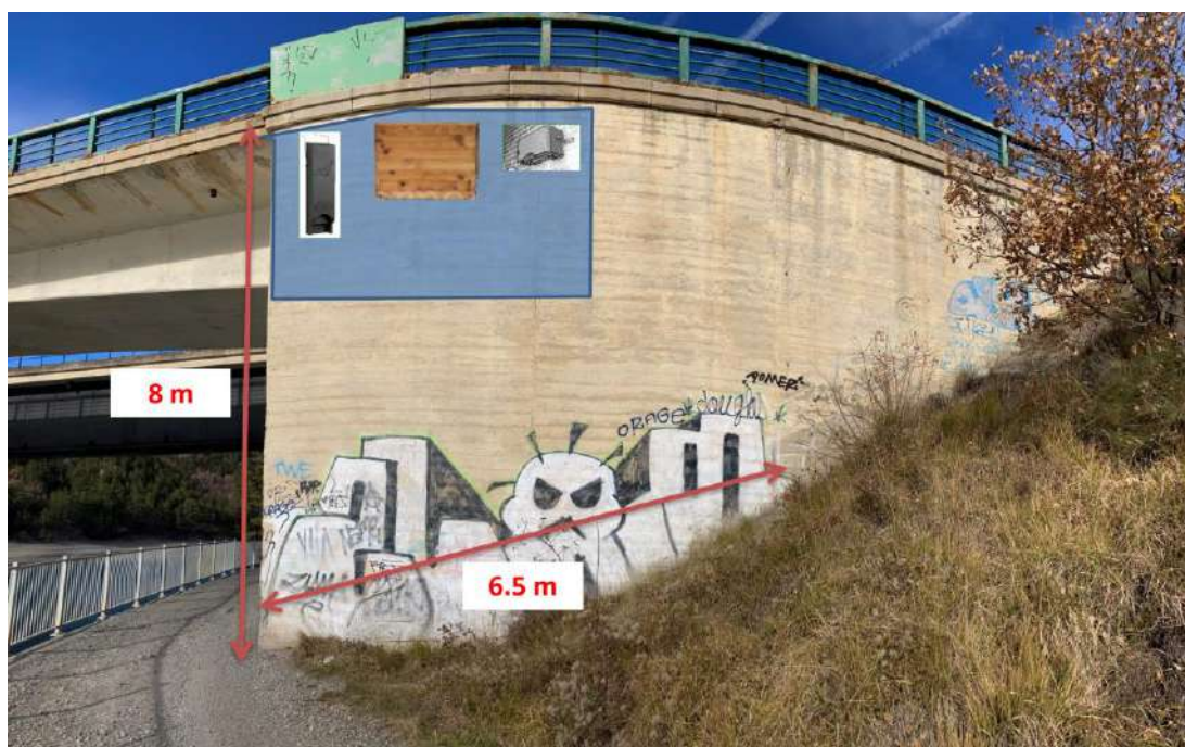
Figure 23 : Proposition d'installation de nichoirs sur le pont Riou Bourdou, face SUD de la culée. Les flèches rouges représentent les dimensions du pont. La bande bleue représente la zone envisagée pour l'installation de 3 nichoirs.
