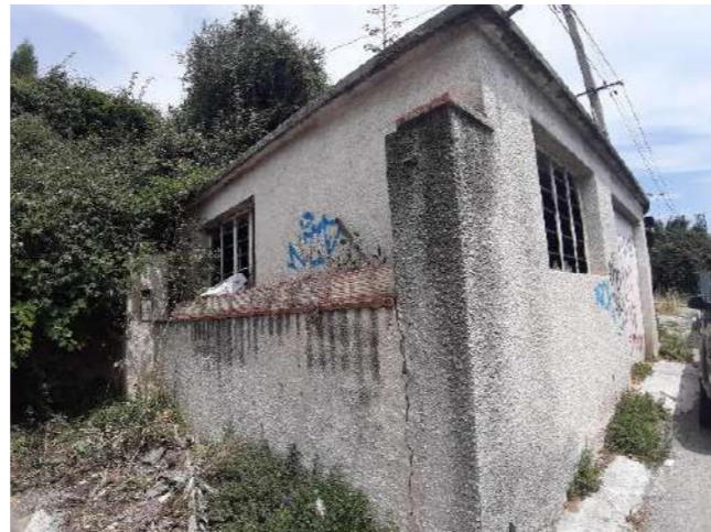
Petit bâtiment abandonné le long du chemin des Paluds, à proximité de la M6098 - © E. VINCENT-CUAZ
