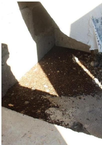
Photographie 2. Galette épaisse de guano sous le ballon d'eau chaude du R+5. © Emmanuel COSSON (GCP), 2025.
