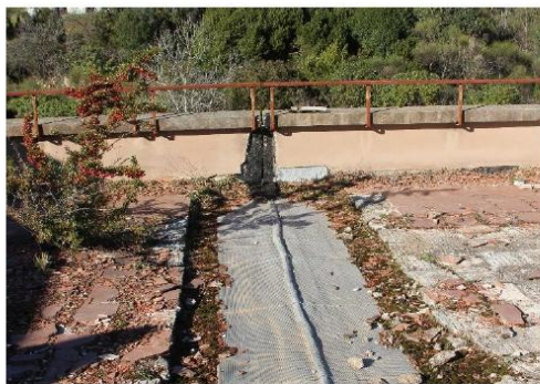
Photographie 10. Solin du toit terrasse en R+4 (aile Est) côté Nord. © Emmanuel COSSON (GCP), 2025.
