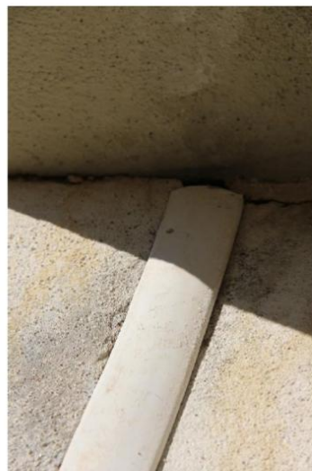
Photographie 13. Joint de dilatation sur la façade Sud de l'aile Ouest en R+4 non étanche. © Emmanuel COSSON (GCP), 2025.
