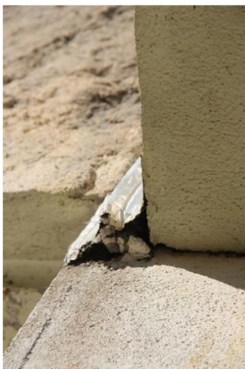
Photographie 14. Bas du joint entre le solin du toit R+5 et la façade Sud de l'aile Ouest qui ne permet pas aux chauves-souris de pénétrer dessous. © Emmanuel COSSON (GCP), 2025.
