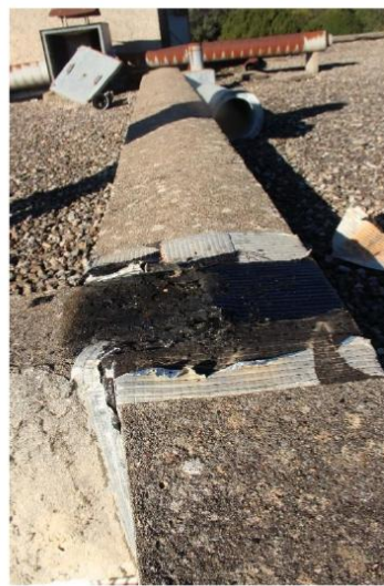
Photographie 15. Jointure entre le joint en façade Sud de l'aile Ouest et le solin du toit R+5 sans passage pour les chauves-souris. © Emmanuel COSSON (GCP), 2025.
