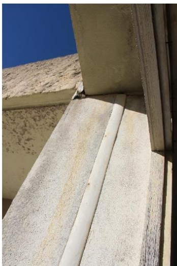
Photographie 12. Joint de dilatation sur la façade Sud de l'aile Ouest en R+4 non étanche. © Emmanuel COSSON (GCP), 2025.
