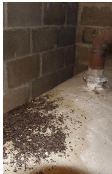
Photographie 3. Guano sur le ballon d'eau chaude du R+5. © Emmanuel COSSON (GCP), 2025.
