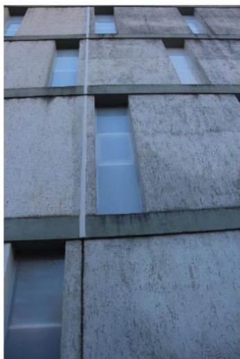
Photographie 8. Joint de dilatation sur la façade Nord de l'aile Est avec présence de guano. © Anaïs ONNO (GCP), 2025.
