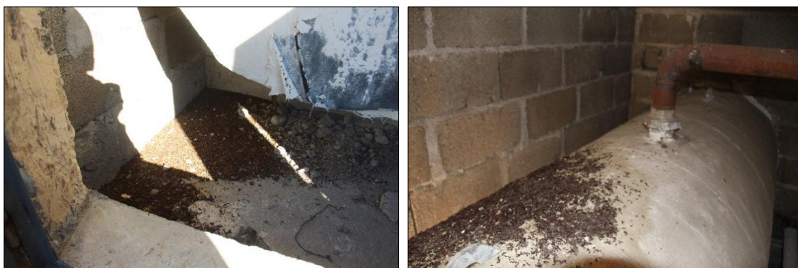
Figure 26 : Photographies de guano au sein du local chauffe-eau, situé sur le toit du bâtiment (Source : GCP, 2025)
