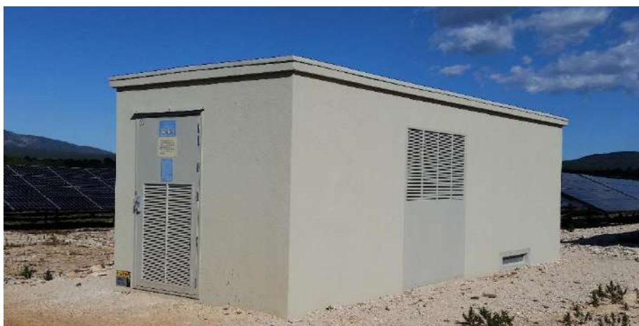
Exemple de poste de transformation – Parc solaire du Castellet
