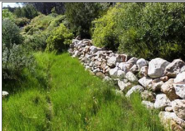
Exemple de muret en pierre sèche très attractif pour les reptiles, alliant gîte bien exposé favorisant l'héliothermie, et la quête alimentaire à proximité immédiate
