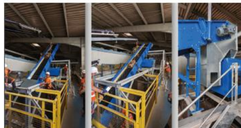
Installation d'un séparateur à Courant de Foucault et de son tapis d'alimentation.
