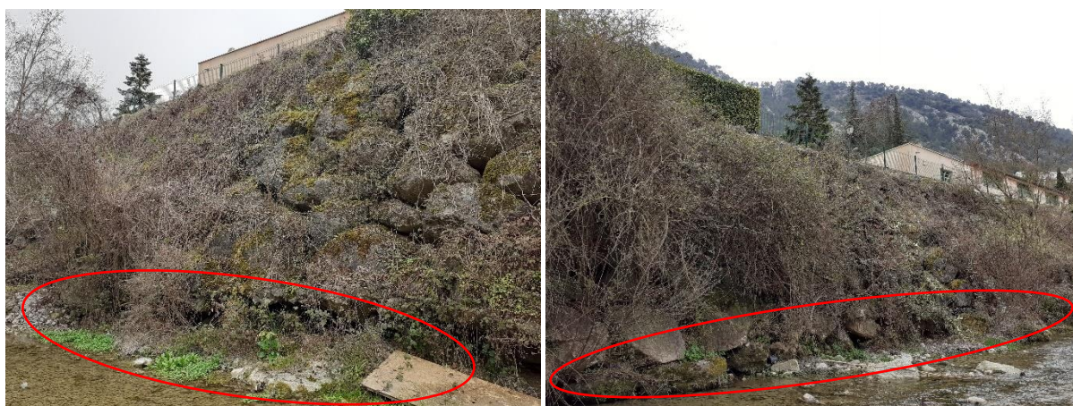
Figure 4 : Photos de la berge à réparer en rive gauche (la zone d'érosion est entourée en rouge) (Source : SEGED 17/03/2022)
