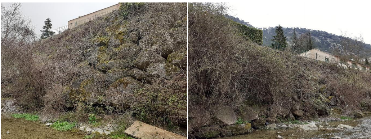
Figure 7 : Photos de la berge à réparer en rive gauche (Source : SEGED 17/03/2022)
