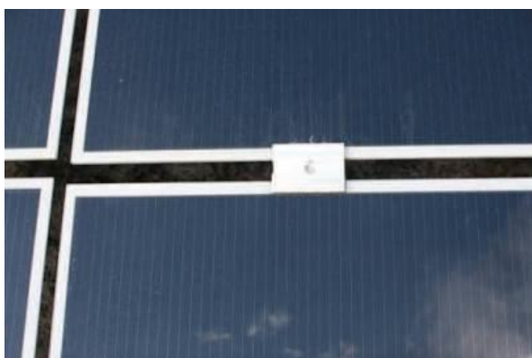
Figure 8 : Interstice entre les modules photovoltaïques (Source : ENGIE PV Sablière du Grand Vallon)
