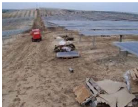
Figure 15 - Photos de chantier – système photovoltaïque traditionnel (sources : SchletterGmbH et ENGIE PV Sablière du Grand Vallon)
