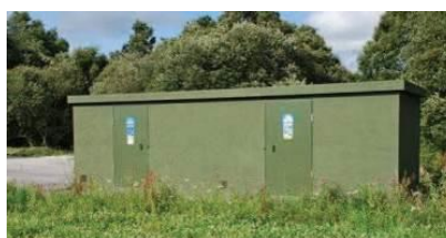
Figure 11 : Poste de livraison
