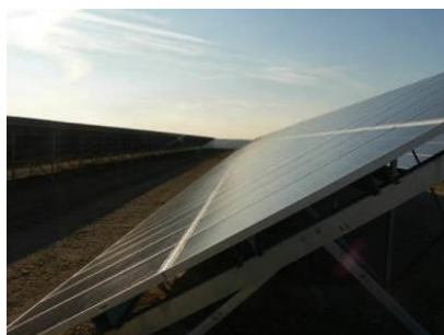
Figure 5 -Modules photovoltaïques inclinés d'un angle de 30° (source : ENGIE PV Sablière du Grand Vallon)
