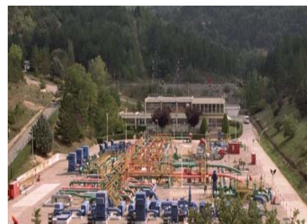
Géosel : station de pompage
