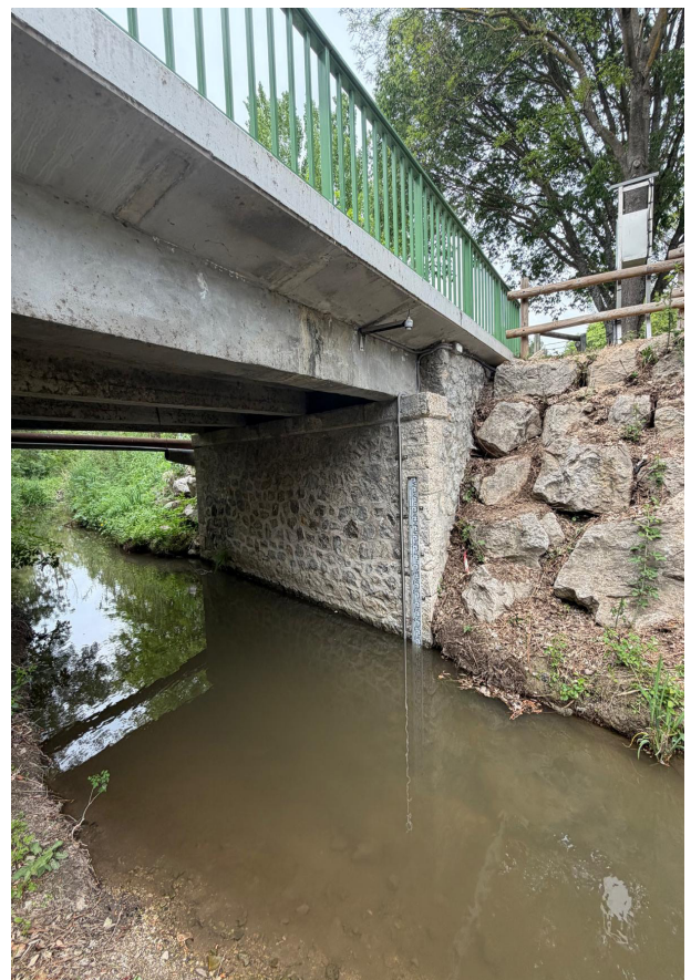
Nouvelle station hydrométrique installée à Puyricard (13) sur la Touloubre fin avril (Source : DREAL PACA)
