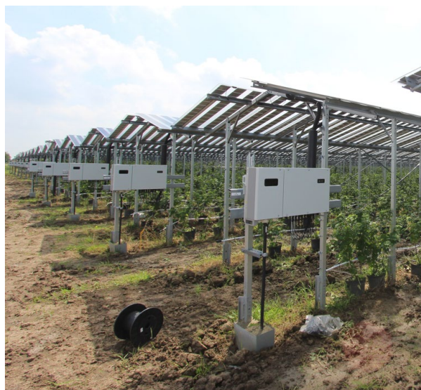
Figure 10 : Exemple d'onduleurs "strings" installés en bout de rangées du site Agri-PV sur groseilles de Wadenrijen, Pays-Bas (source : BayWa r.e.)
