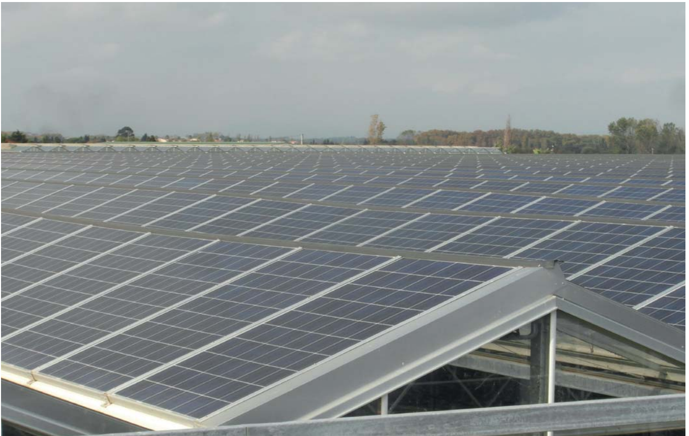
→ TOITURE D'UNE SERRE. PAN DES PANNEAUX PHOTOVOLTAÏQUES
