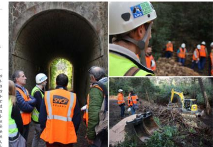
Les abords de ce pont, situé sous la voie ferrée, sont aménagés avec des murets, une mare, et des nichoirs pour servir d'habitat et inciter les différentes espèces à l'utiliser comme passage. www.lpo.fr
