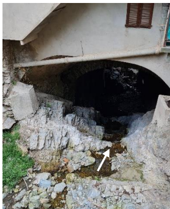
Lit du cours d'eau sous les habitations (écoulement sur la roche mère)
