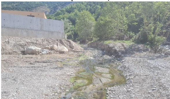
Rejet de la station d'épuration
