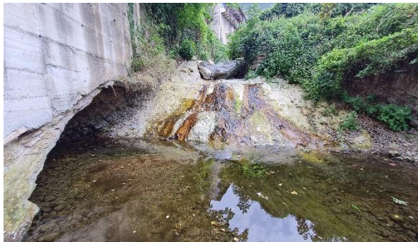
Obstacle infranchissable pour la faune piscicole
