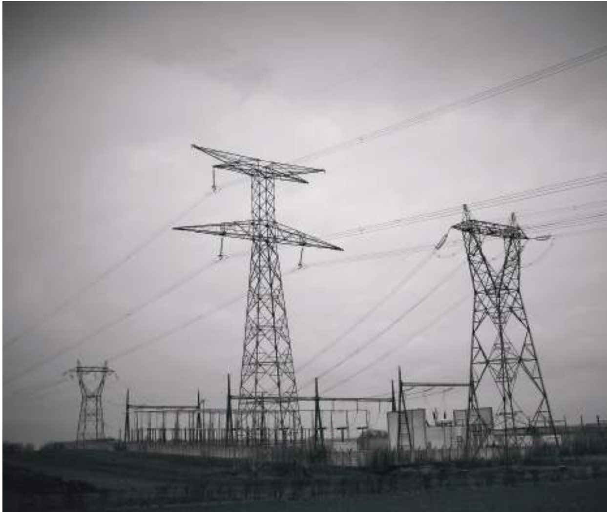
Le poste-source de Coupelle-Neuve - Crédits photo
