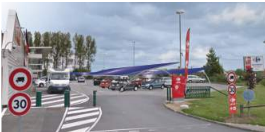
Ombrières photovoltaïques installées sur le parking du supermarché à la sortie de Fruges.
