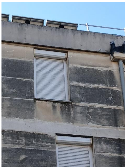
Coffres de volet roulant et corniches en béton favorables à la nidification des oiseaux V.GAILLY, le 19/03/2026, Arles (13)
