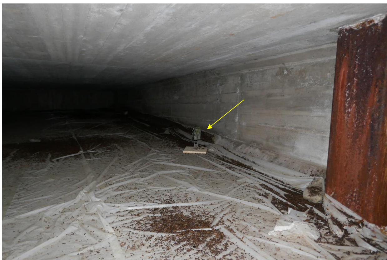
Aperçu de l'appareil n°2 dans le caisson n°3 L. TREBUCQ, 15/10/2020, Guillestre (05)
