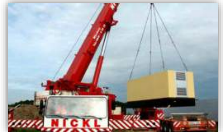
Exemple d'acheminement d'un poste de livraison préfabriqué
