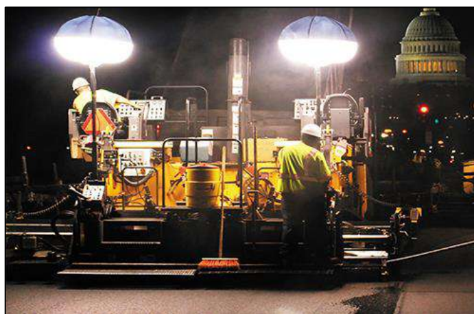
Exemple d'éclairage monté directement sur les engins de chantier, avec occultation de la partie supérieure afin de limiter à <1% de l'éclairage au-dessus de l'horizontale) - Ballons éclairants Airstar®
