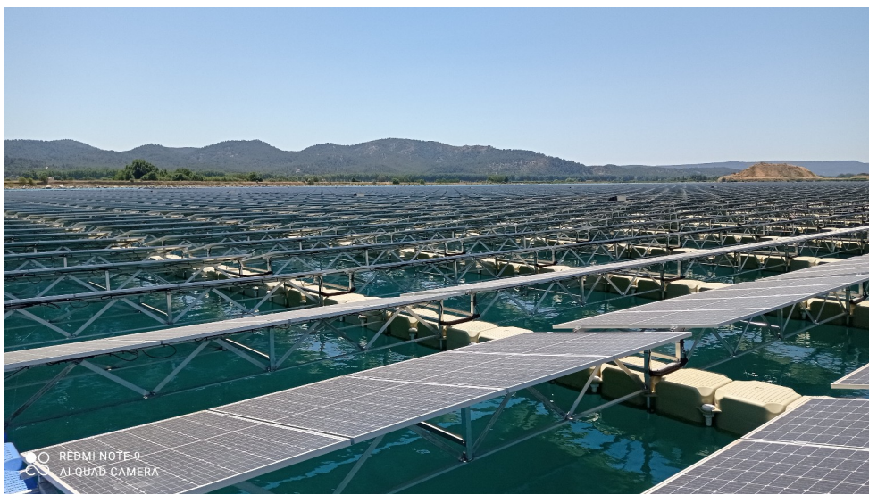
Parc photovoltaïque flottant Peyrolles
