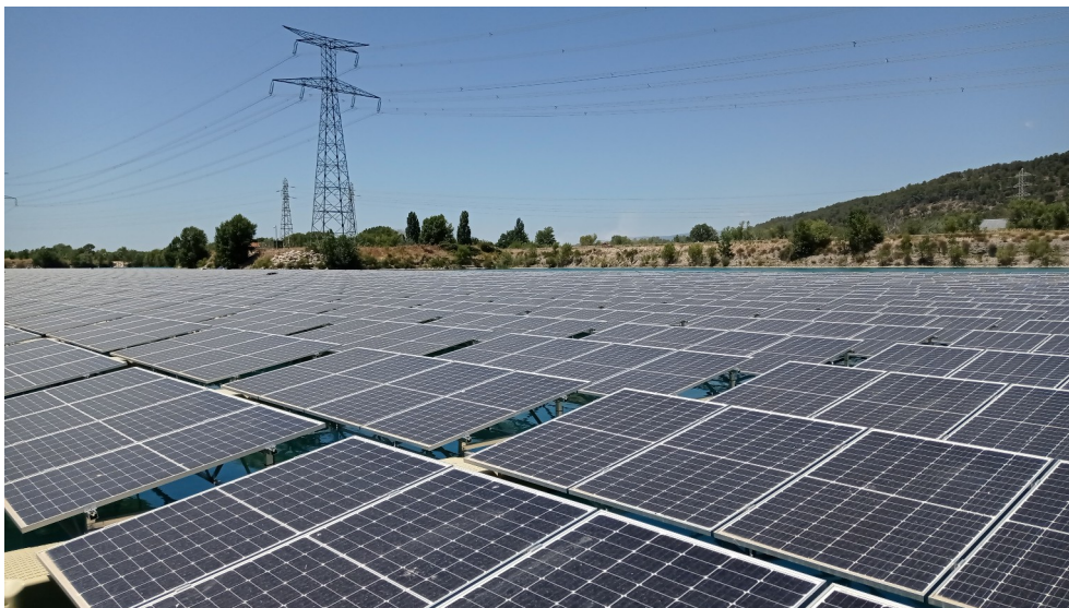
Parc photovoltaïque flottant Peyrolles
