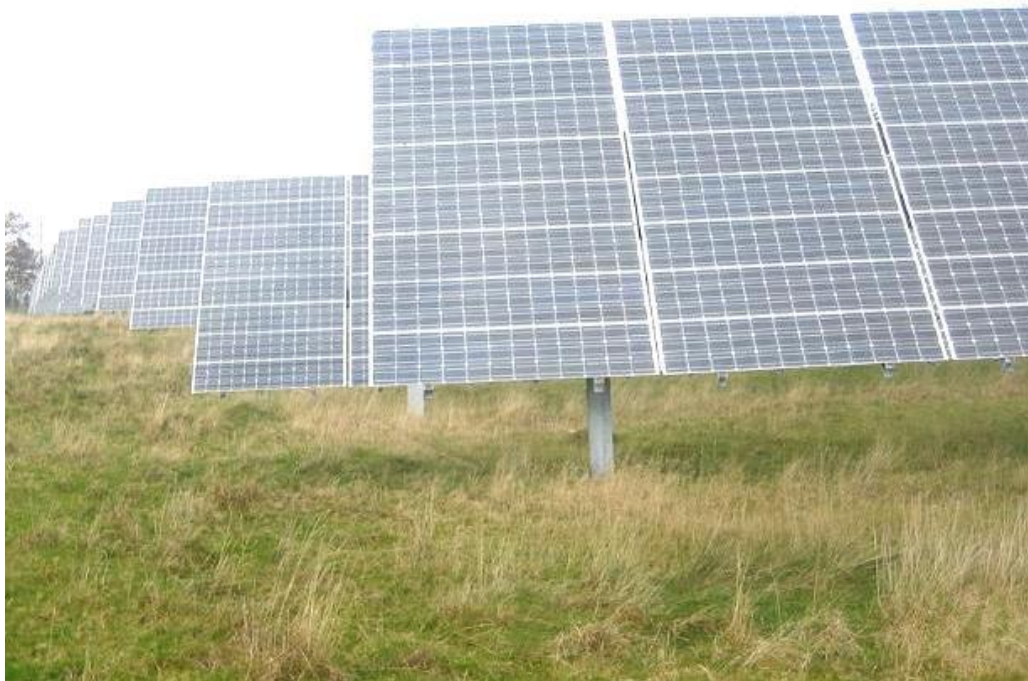
Figure 7 : Vue des structures porteuses des panneaux (Gaitasan)
