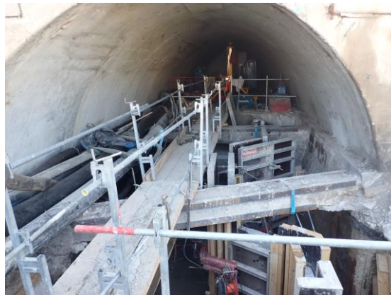
Illustration 18 - Galerie de la mer (13) - Construction d'une unité d'exploitation géothermale des eaux de la cunette de la galerie de la mer.
