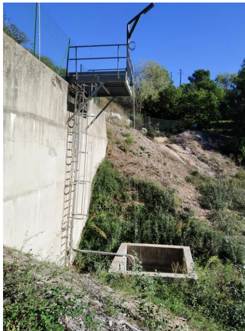
Illustration 10 - Bassin des Sauvaires – Mur de soutènement affecté par un faux-aplomb - Commune de Gardanne (13).
