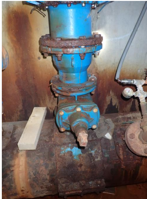
Illustration 16 - Galerie de la mer – Vanne fuyarde au Cap Pinède - Marseille (13).
