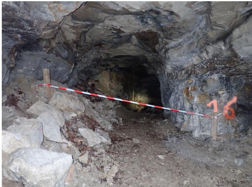
Illustration 33 - Mine des Camoins – Exemple de zone soumise à instabilités – Marseille (13)
