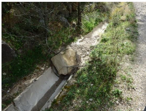
Illustration 27 - Terril des Sauvaires – Exemple de caniveau mal entretenu - Gardanne (13).
