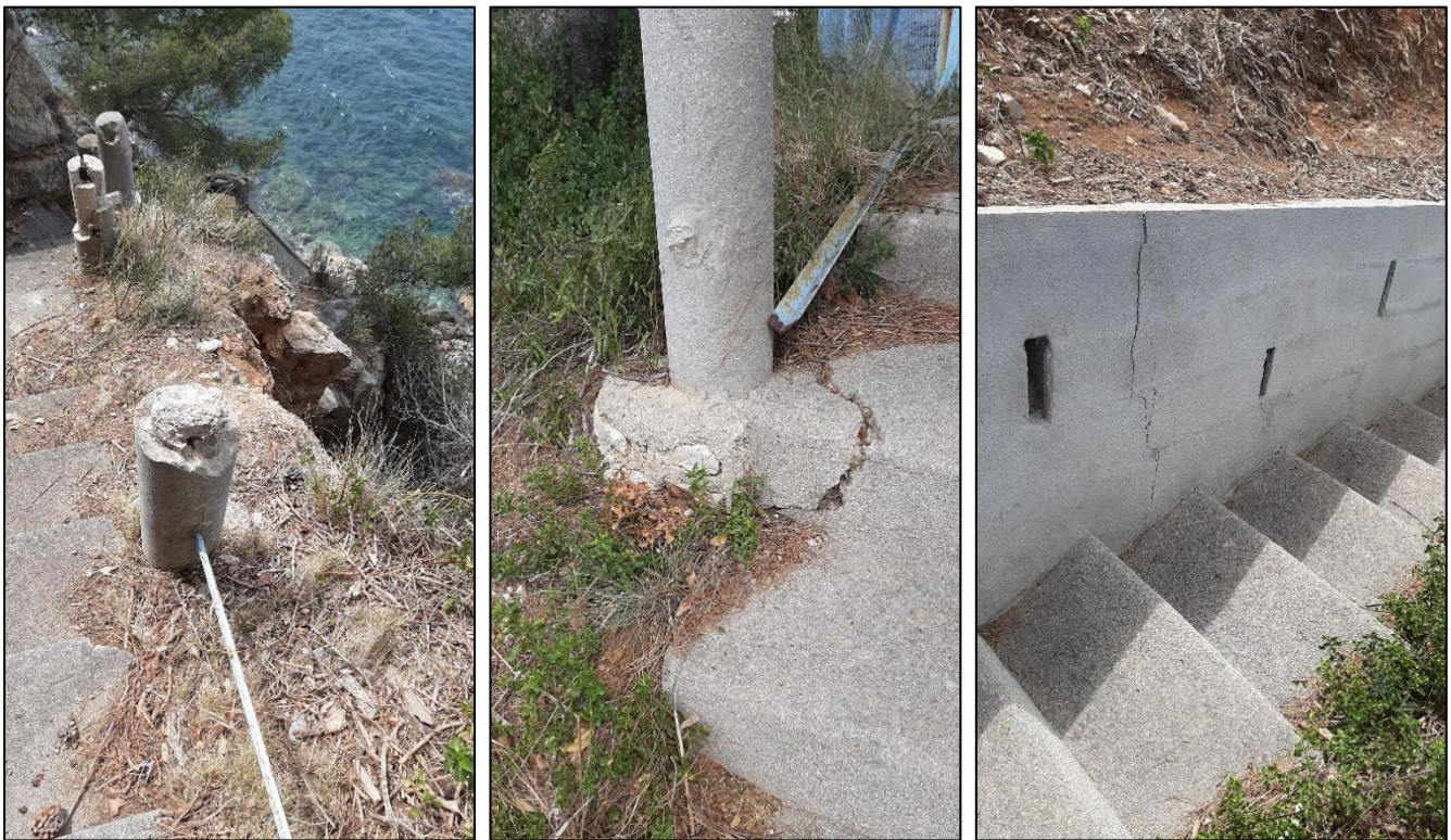
Figure 14 : Photo des désordres constatés au droit de l'escalier
