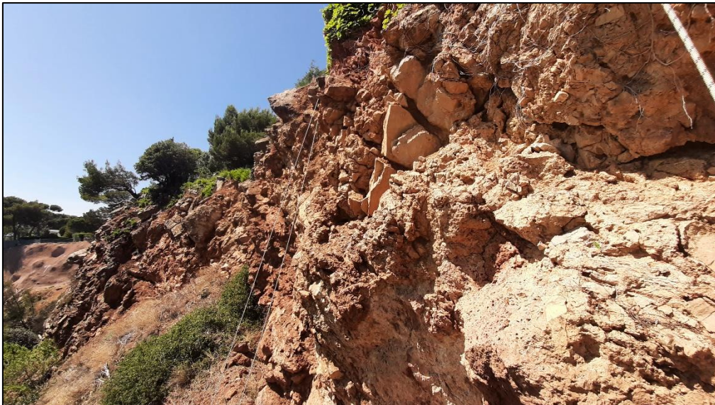
Figure 41 : Photo de la falaise au droit de la parcelle AW 256
