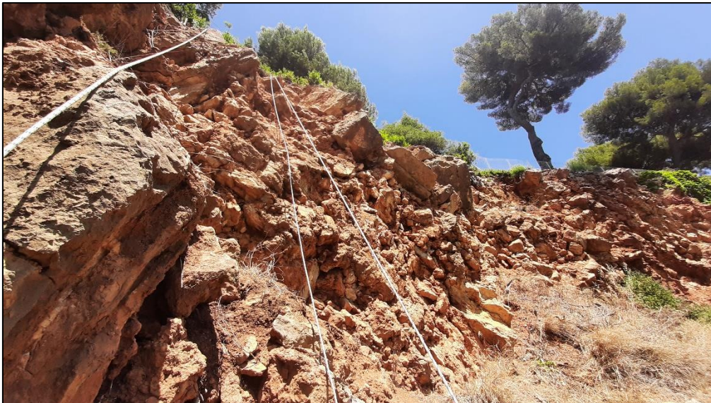
Figure 38 : Photo de la falaise au droit de la parcelle AW 257
