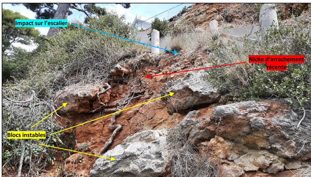
Figure 15 : Photo d'une cicatrice d'un éboulement récent
