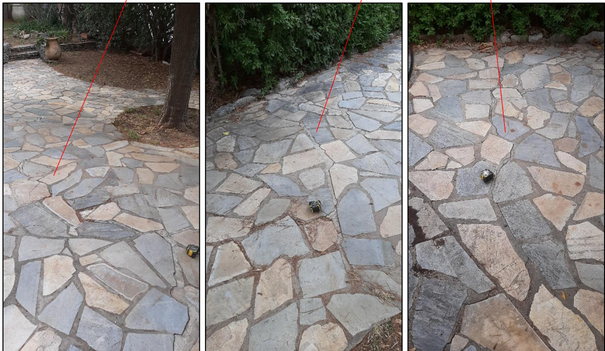
Figure 29 : Photo des désordres constatés sur la propriété AW-259
