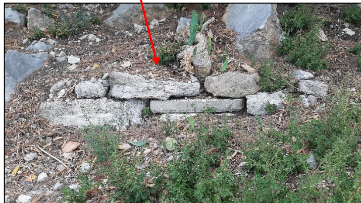
Figure 27 : Photo du talus L1 sous la propriété AW-259
