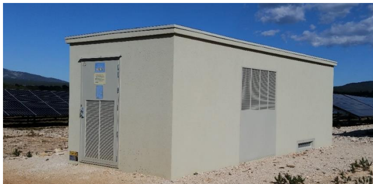
Exemple de poste de transformation – Parc solaire du Castelet – Source : VOLTALIA
