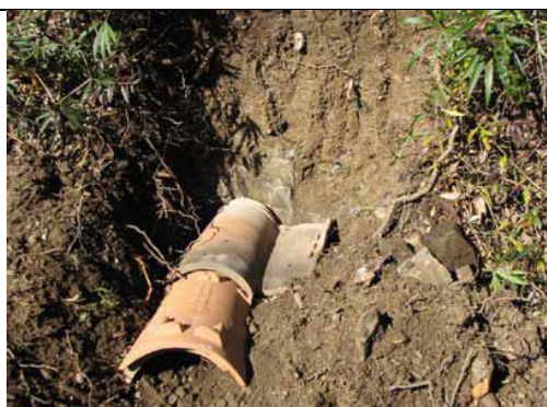
Tuiles déposées dans le surcreusement (de préférence à au moins 40 ou 60 cm de profondeur), constituant un abri hors gel
