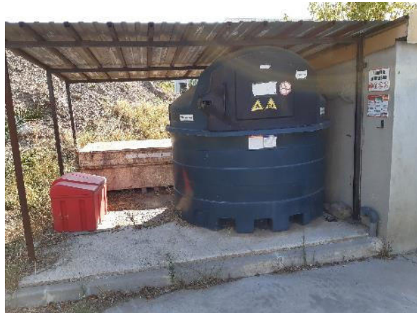
Photographie 8 : Cuve aérienne de fioul
