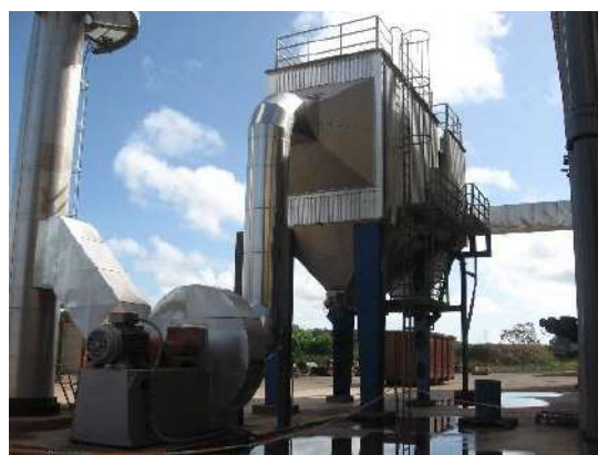
Centrale biomasse – Source : VOLTALIA
