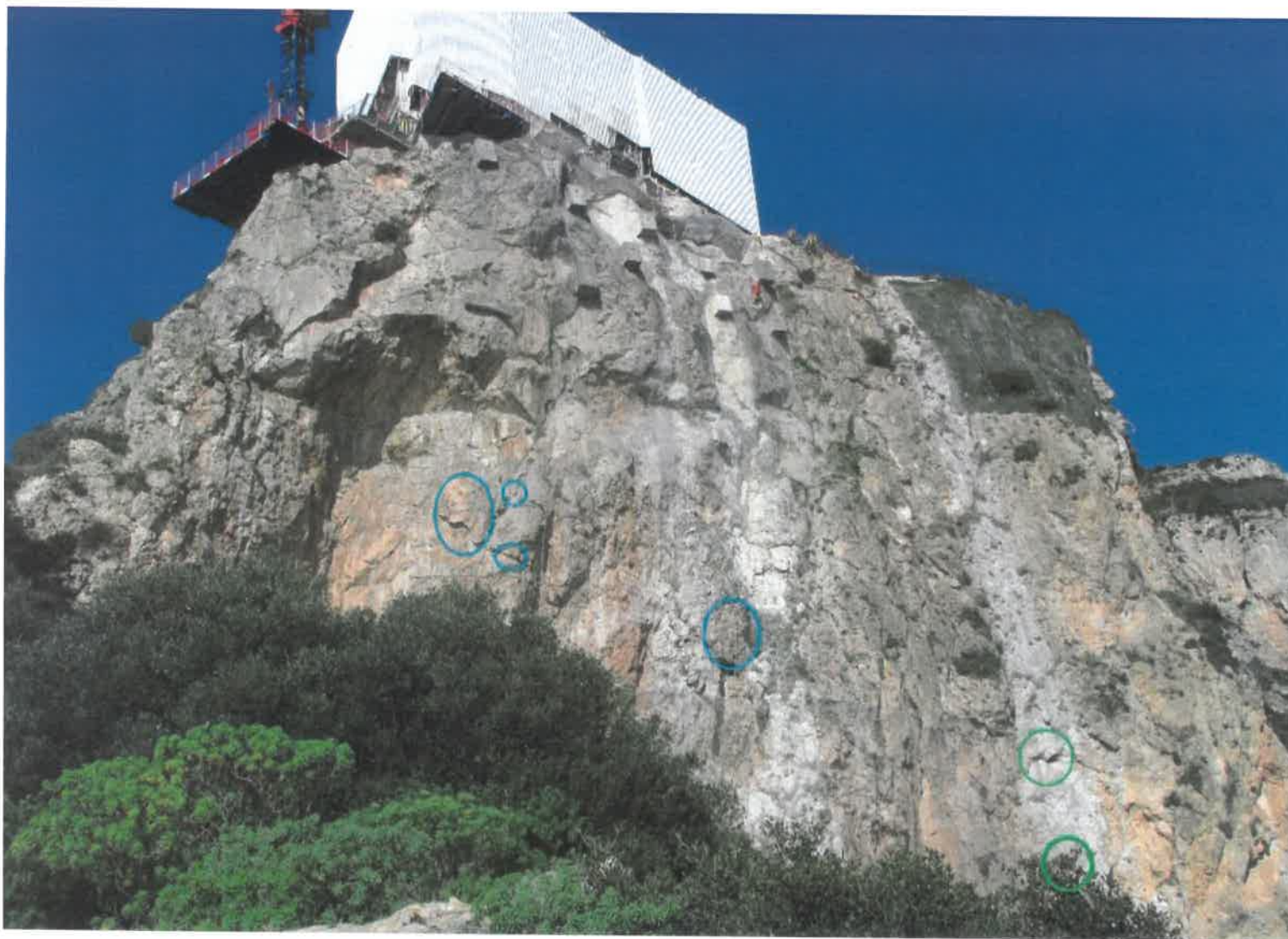
Gîtes impactés par la pose de filets (cerclés de bleu) prévus pour être réouverts et par les coulures (cerclés de vert)
