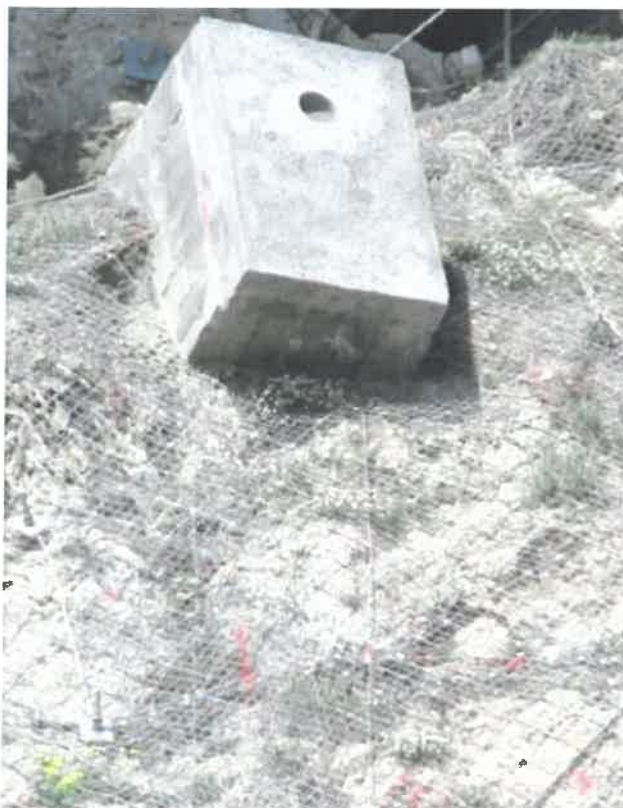
Végétation (non protégée) en floraison sous un bloc béton B. TEUF, 13/02/2019, Roquebrune-Cap-Martin (06)
