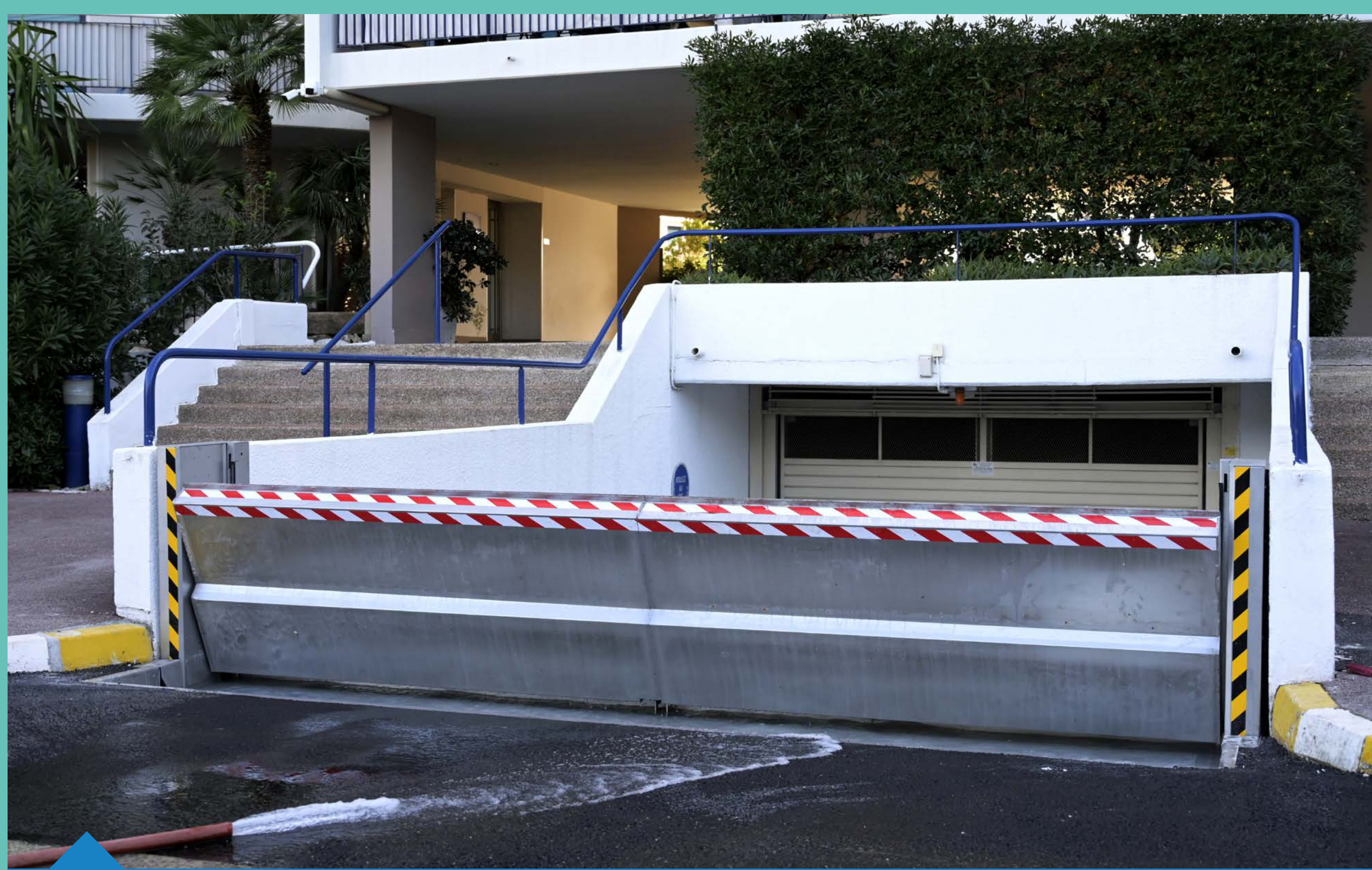
Photo batardeau copropriété Mandelieu-la-Napoule (Source © Agglomération Cannes Lérins)
