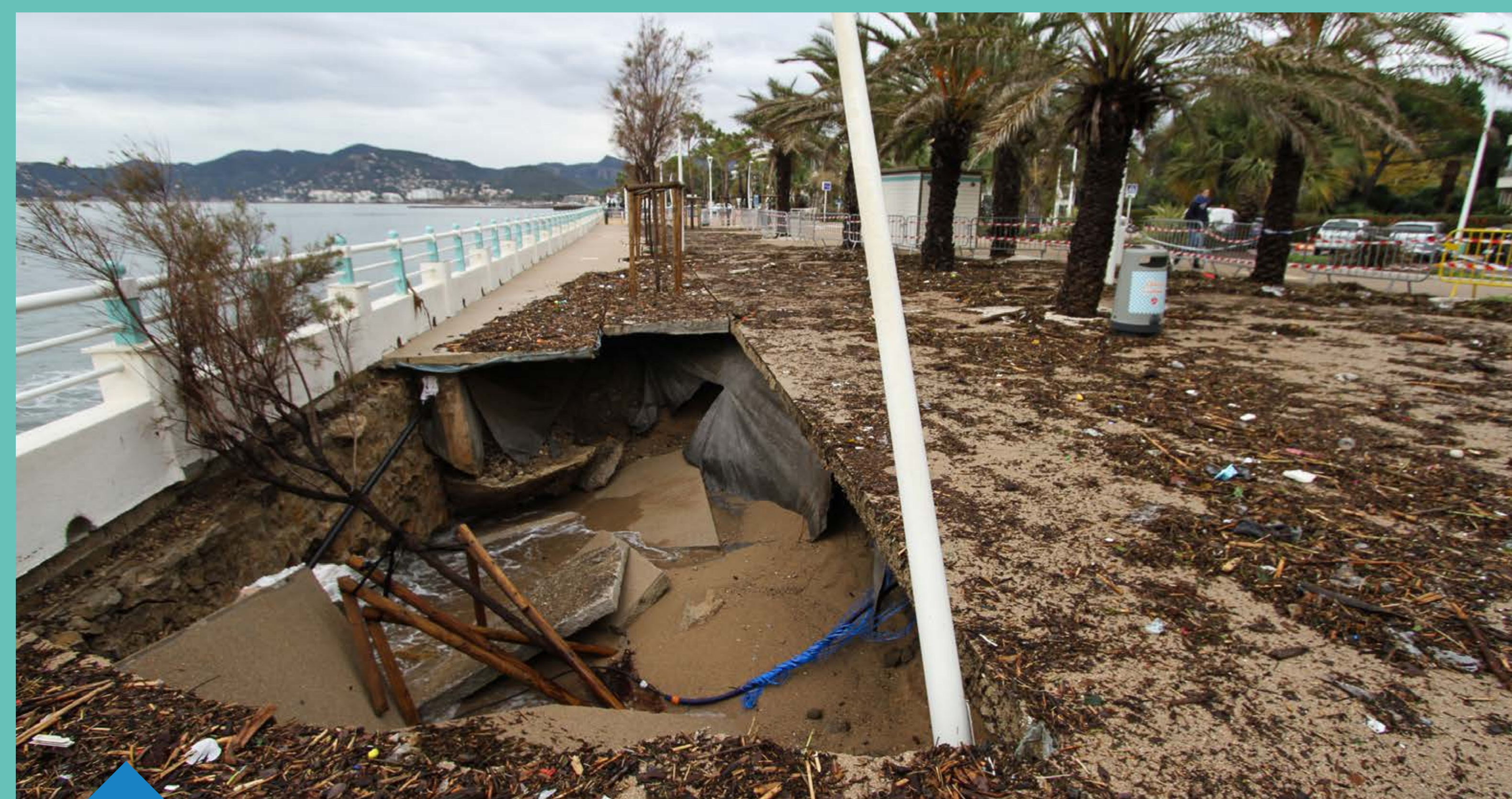
Dégâts à la Bocca suite aux inondations de novembre 2019 - ville de Cannes (Source © mairie de Cannes)
