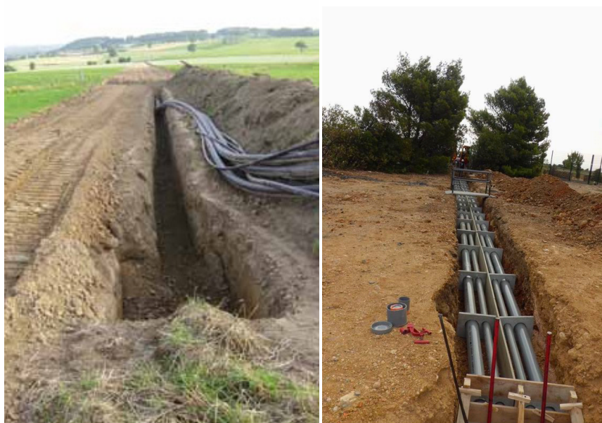
Câbles en pleine terre (à gauche) et fourreaux PVC (à droite) enrobés dans du béton (à droite)
