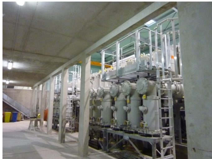
Installations électriques d'un PSEM
