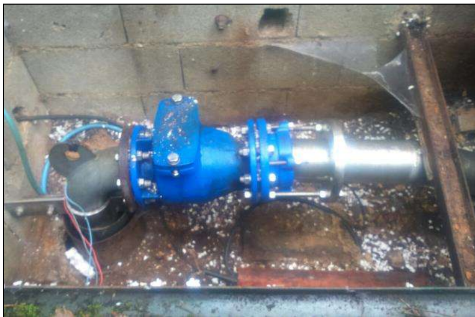
Figure 2 : Photographie de la pompe du forage 2
