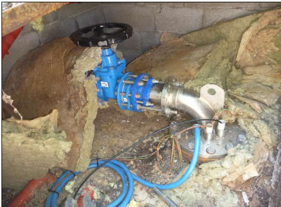
Figure 4 : Photographie de la pompe du forage 3
