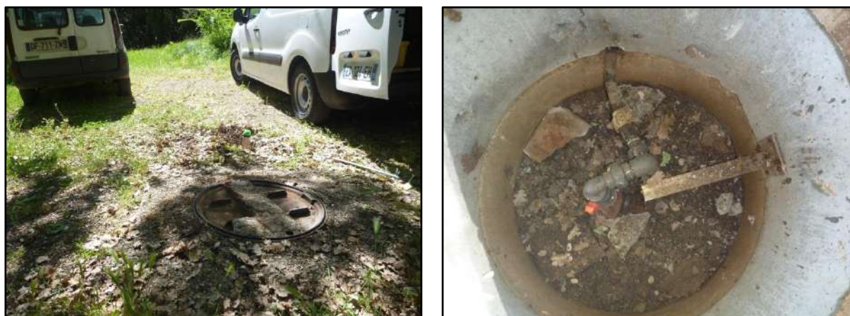
Figure 3 : Photographies du point d'injection du chlore dans le réseau d'adduction
