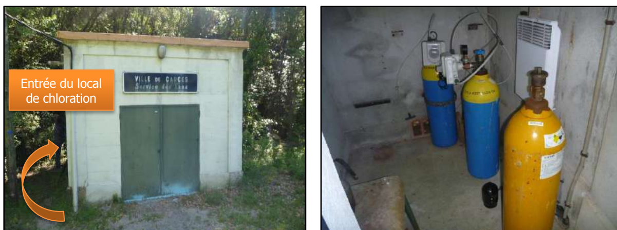
Figure 1 : Photographies de l'accès au local de chloration et des bouteilles de chlore gazeux
