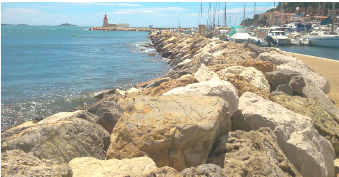
Photo 3 : Digue du quai du Levant, en partie déstructurée.
