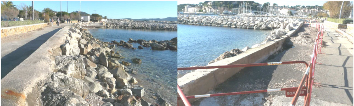
Photo 6 : Enrochements de protection de l'Esplanade : déstabilisation des enrochements et effondrement de la promenade / voie de service.
