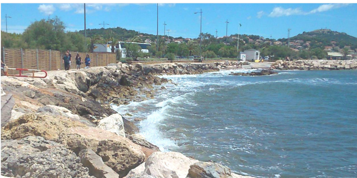
Photo 4 : Enrochements de protection déstructurés, effondrement de la voie de service / promenade longeant l'Esplanade.
