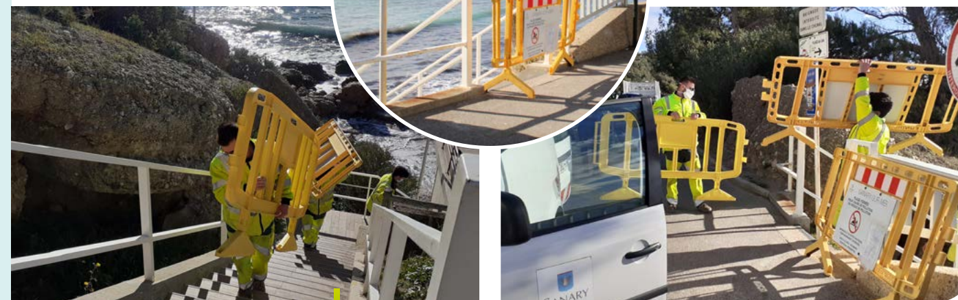
Installation du barriérage sur le littoral de Sanary-sur-Mer par les services techniques (source MIIAM)
