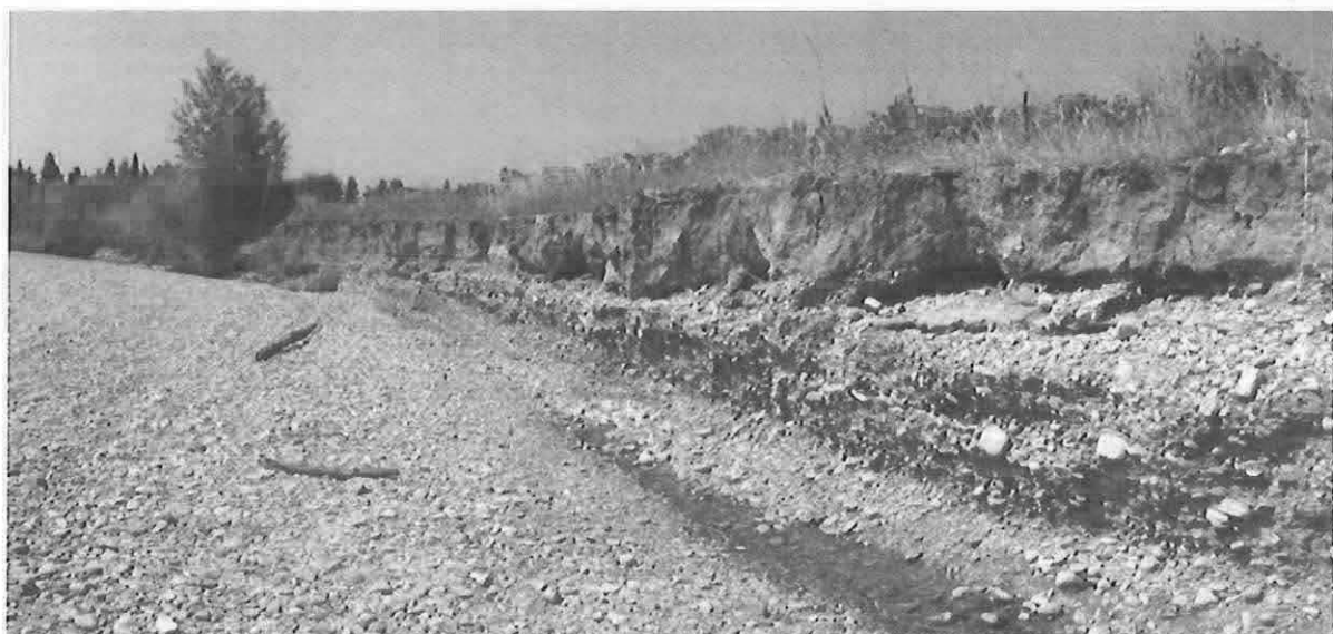
Photo 1: Etat de la berge rive droite à protéger – Front d'érosion marqué
