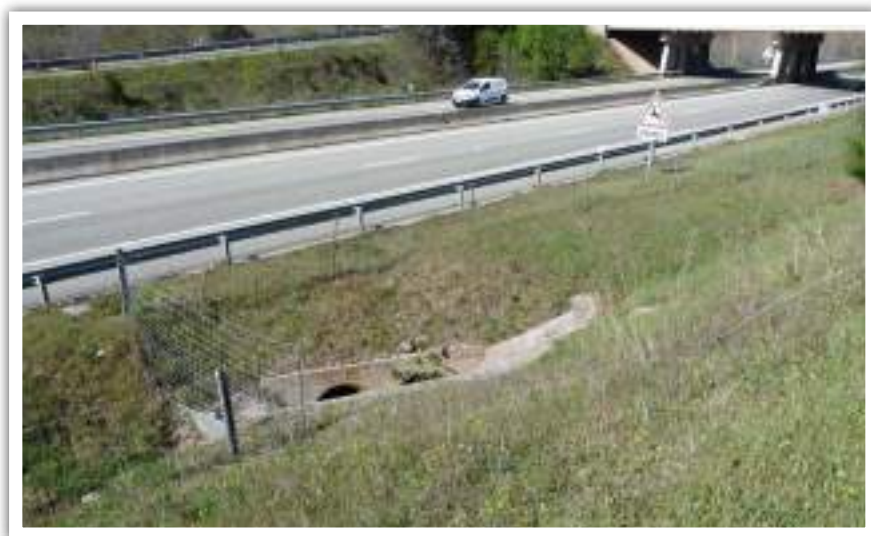
Double buse de l'ouvrage n°12, vu côté est, entre l'A57 et le chemin du Taco, au niveau d'une ouverture à ciel ouvert © Micaël GENDROT
