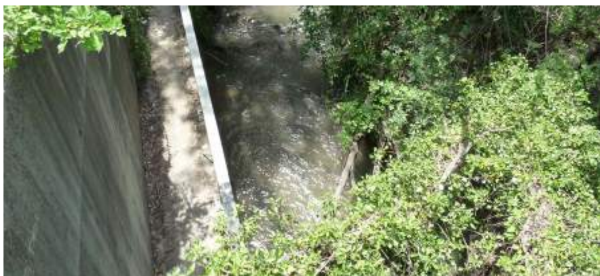
Trottoir à gauche de l'image permettant le passage à pied sec le long d'un cours d'eau passant sous la chaussée © Micaël GENDROT
