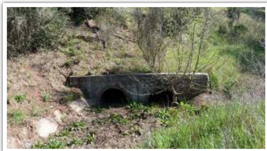
Ouvrage n°5 constitué d'une double buse à demi bouchée © Micaël GENDROT
