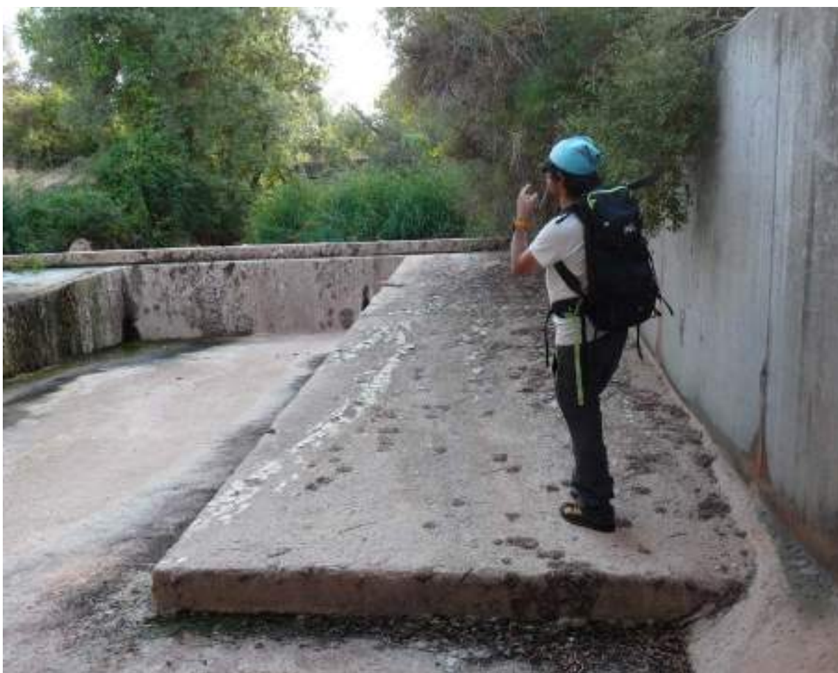
Rampes béton (ici un répartiteur) permettant à la faune de franchir aisément un seuil © Micaël GENDROT
