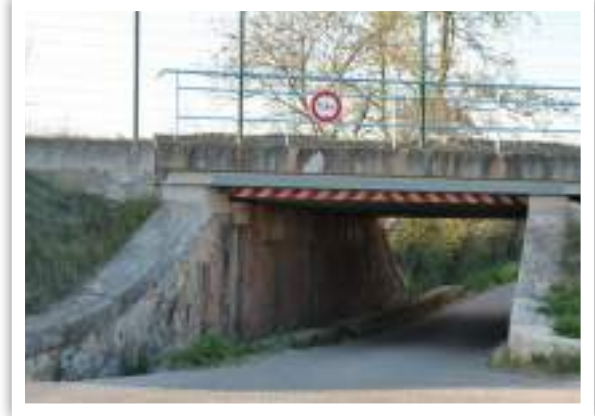
Ouvrage n°16. Le ruisseau canalisé coule sur le côté gauche de l'image © Micaël GENDROT
