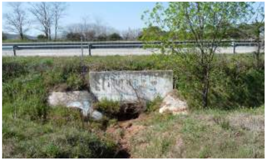
Ouvrage n°14 constituée d'une buse à demi-obstruée © Micaël GENDROT
