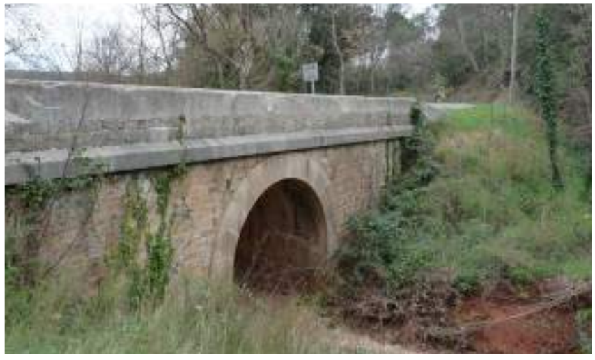
Passage de la RD24 au-dessus du vallon de Pey Coucu © Micaël GENDROT
