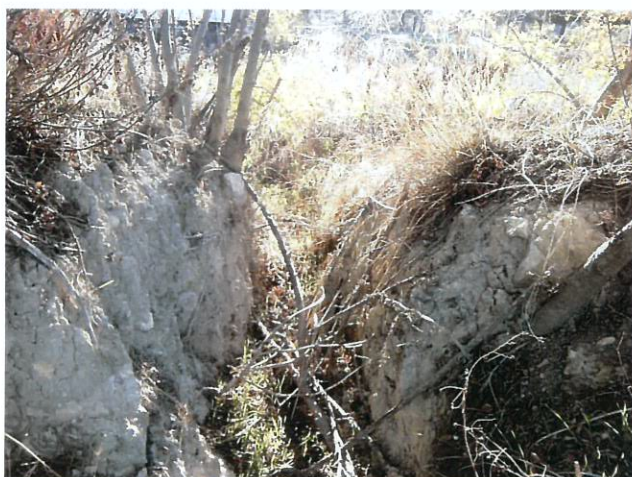
Photo 3 : brèche dans le remblai
