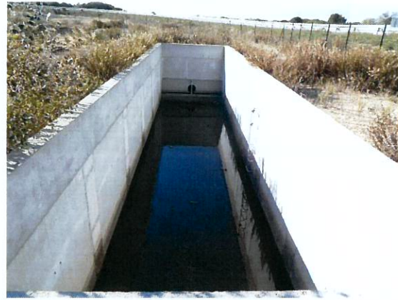
Séparateur à hydrocarbures bétonné
