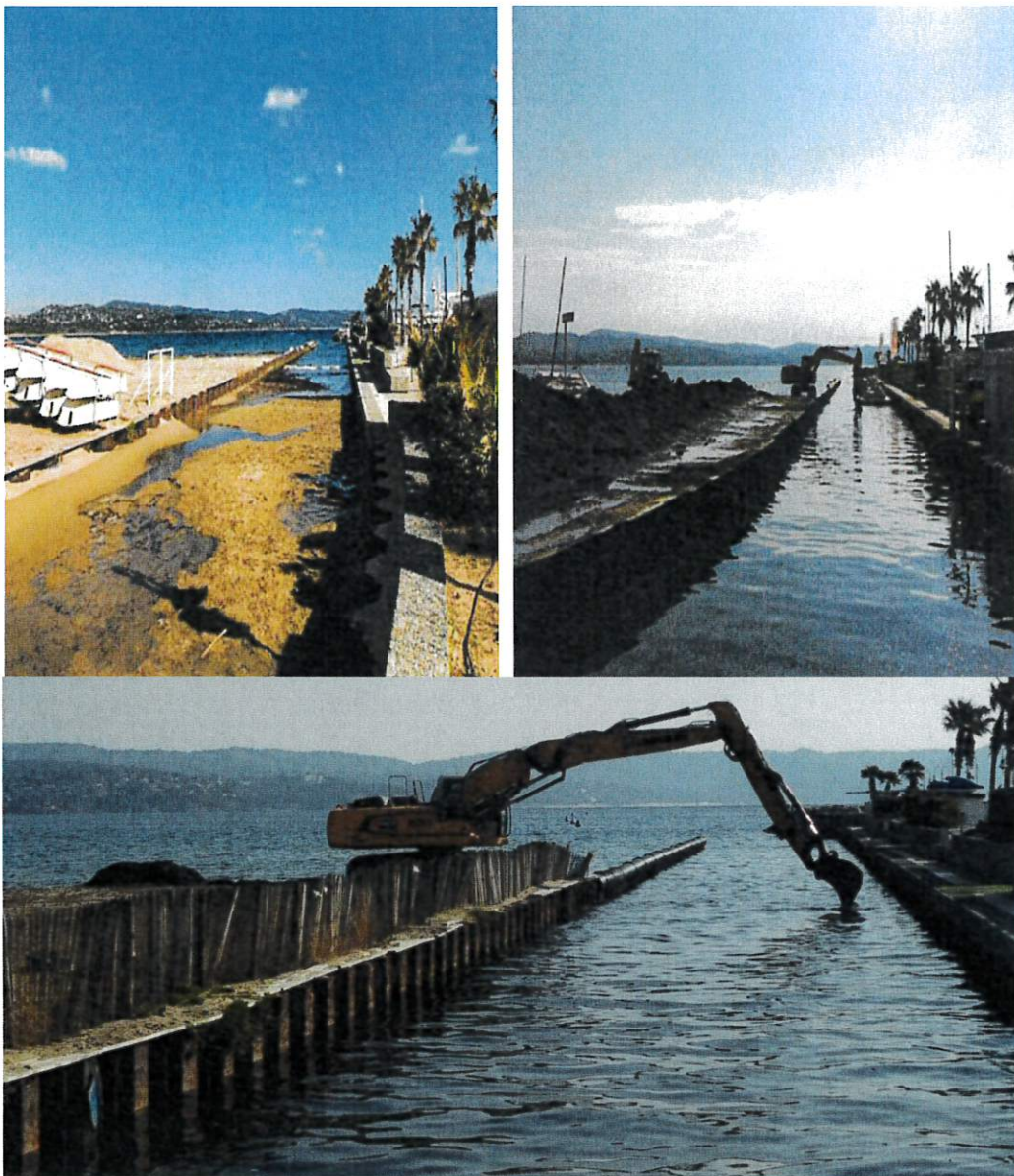
Figure 3 : Illustration de l'embouchure colmatée par les feuilles mortes de Posidonie et les sables (à gauche) ; et des travaux de dragage mécanique (à droite et en bas)
