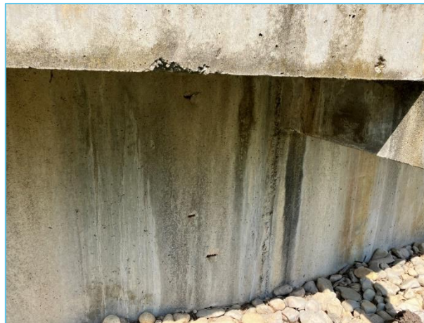
Epaufures sur clarificateur 2
