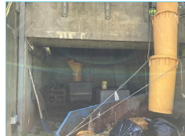
Stockage des refus
