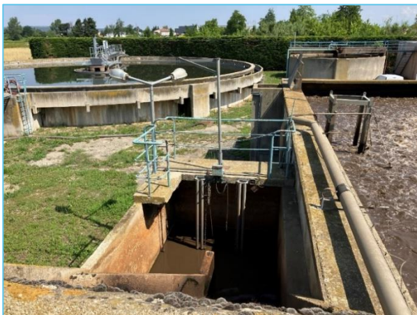
Poste de recirculation
