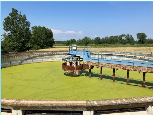
Clarificateur 2 à l'arrêt
