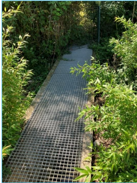
Canal de by-pass entrée
