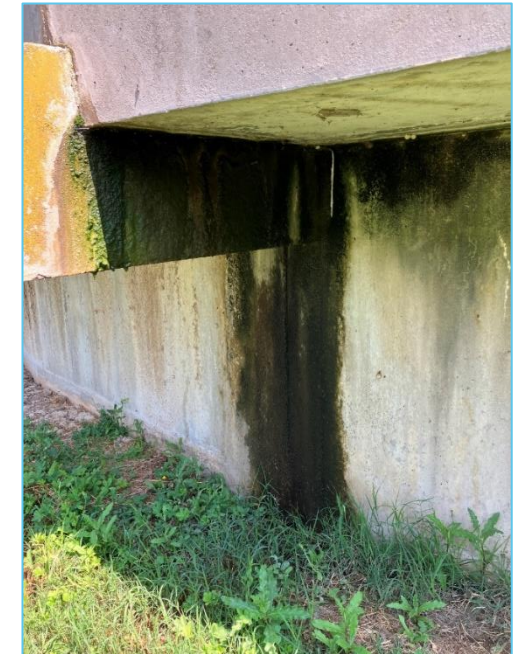
Fuite sur clarificateur 1
