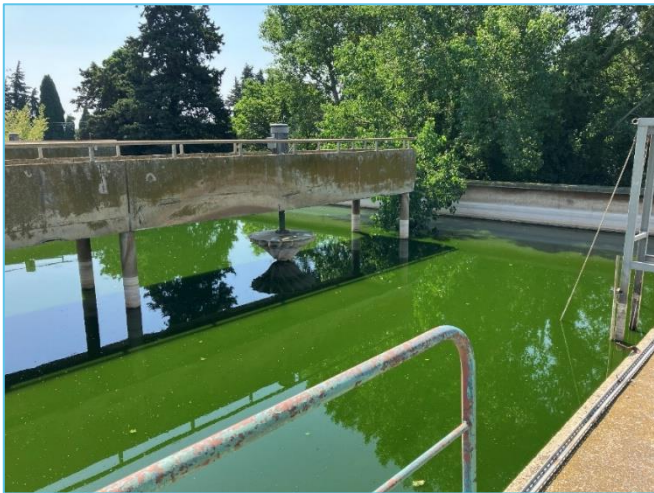
Bassin d'aération 2 à l'arrêt
