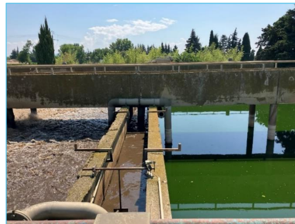
Canal de recirculation
