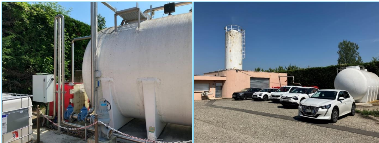
Injection réactifs industriels
