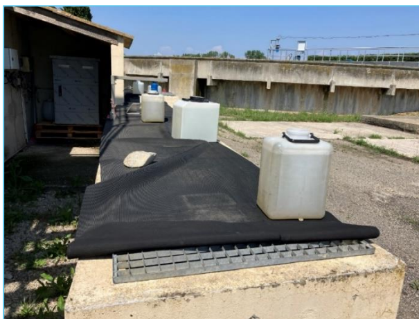
Canal venturi sortie
