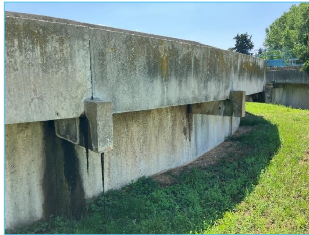
Fuite sur clarificateur 1
