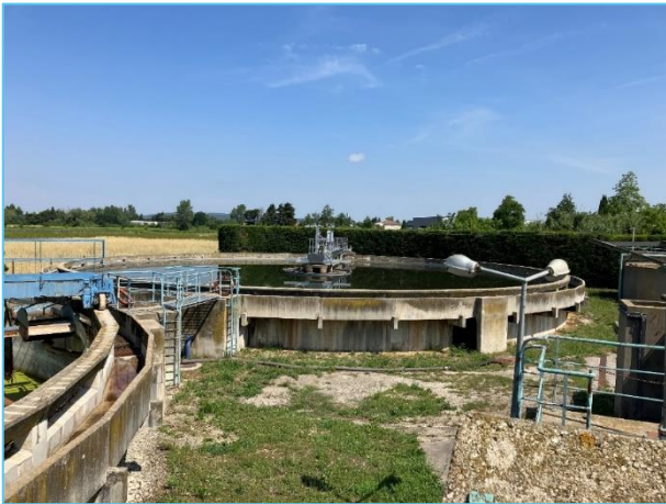
Clarificateur 1 en service
