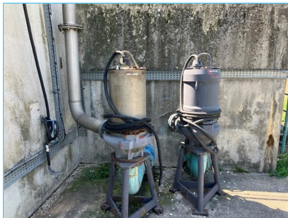
Pompes de recirculation
