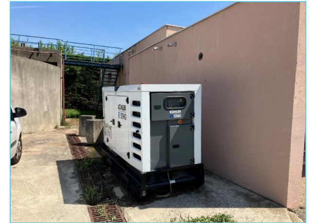
Groupe électrogène de secours extérieur
