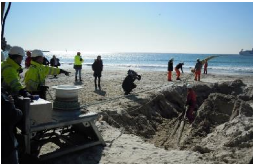
Figure 19: Opération de tirage du câble à terre avec un cabestan hydraulique (source : Orange marine)
