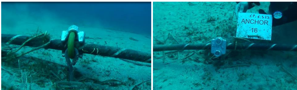
Figure 26 : Autre système de fixation du câble à l'ancre visant à limiter le risque de croche de l'ancre dans les filets de pêche (Orange Marine)
