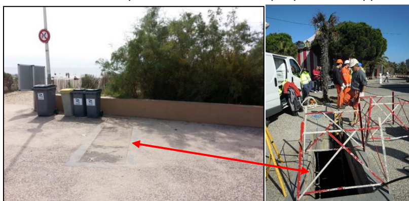
Figure 2 : Vues extérieures d'une chambre-plage : fermée et ouverte (setec in vivo)
