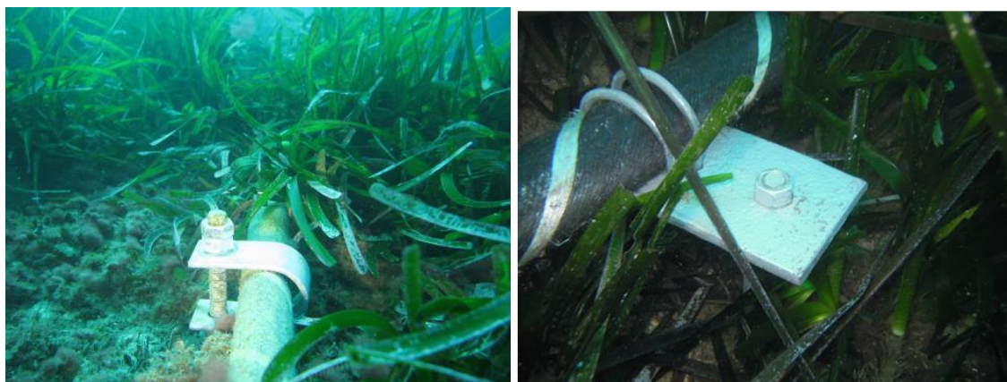
Figure 25 : Deux systèmes de fixation d'ancres à vis installées en zone d'herbier (photo : setec in vivo)
