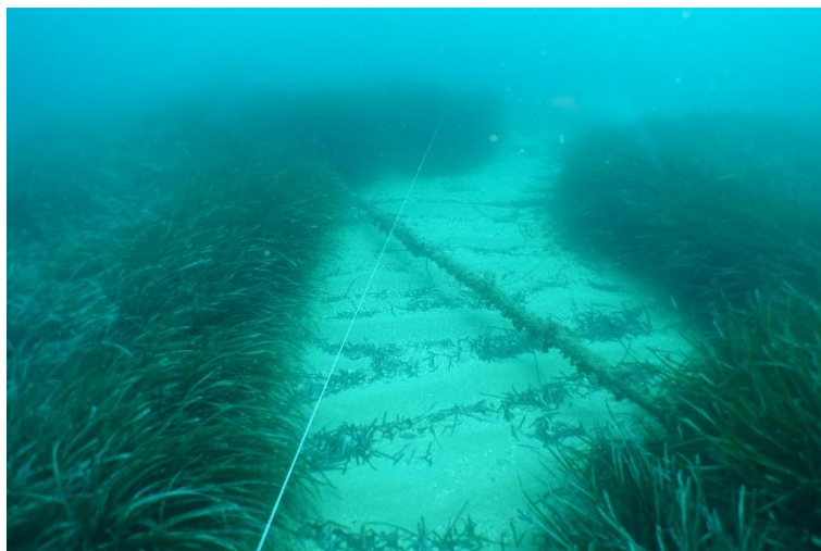
Figure 75 : Câble télécom en suspension au passage d'une zone d'intermatte (Marseille, 2020)
